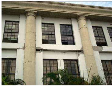
Figura 3. Daños en edificios
