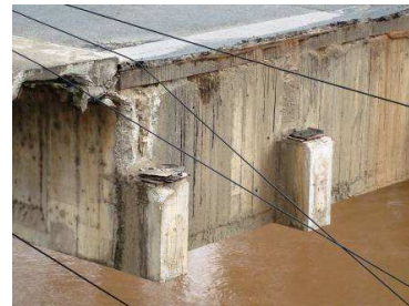
Figura 8. Colapso del tramo central del puente antiguo
