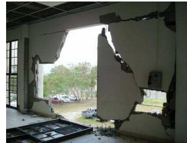
Figura 12. Edificio con serios daños
