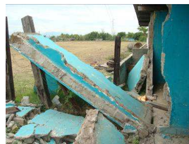
Figura 2. Daños en casas de habitación
