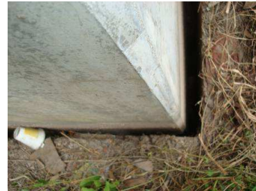
Figura 7. Desplazamientos de estructuras
