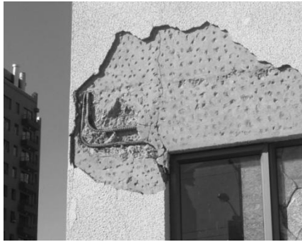
Figura 22.- Acero de refuerzo sin confinamiento-Chile.
