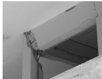
Figura 26.- Inadecuada cantidad de refuerzo en unión viga columna-Haití.
