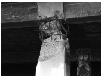
Figura 16.- Edificación sin colapsar con daños a causa de viga fuerte y columna débil-Haití.
