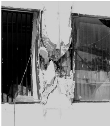
Figura 11.- Fallo por columna corta-Haití. (Tomada de Carvajal, 2011)
