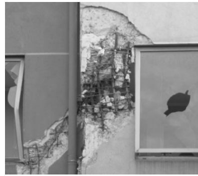
Figura 12.- Fallo por columna corta-Chile.
