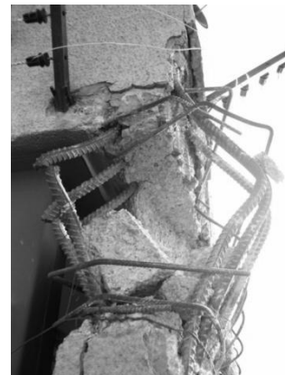
Figura 21.- Pandeo del refuerzo estructural por inadecuado confinamiento-Chile. Nótese el pandeo y ruptura del refuerzo principal. (Tomada de Carvajal 2011)
