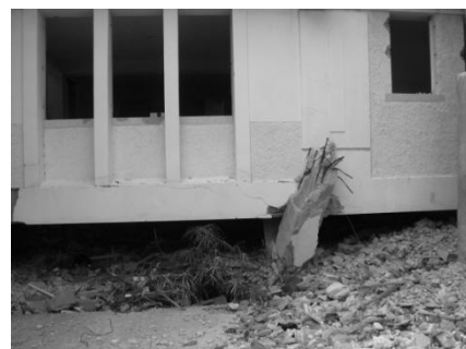
Figura 14.- Colapso por piso débil-Haití. Nótese transición entre columnas y muros.
