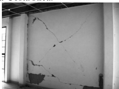
Figura 28.- Participación de muros en la respuesta estructural -Honduras. Nótese también el daño en el muro (Tomada de Carvajal, 2011)
