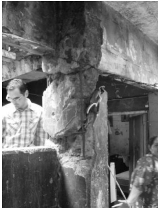
Figura 9.- Fallo por columna corta-Nicaragua.
