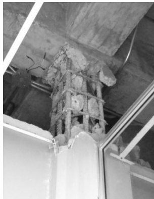
Figura 10.- Fallo por columna corta-Honduras. (Tomada de Carvajal, 2011)
