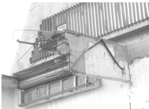
Figura 20.- Escaso refuerzo de columna del primer piso de un edificio con más de 10 pisos de altura que colapsó durante el terremoto–Chile.
