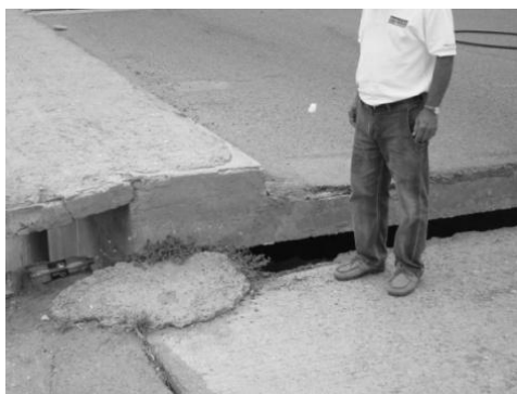
Figura 4.- Afectación debido a la licuefacción de las arenas soportante-Honduras. (Tomada de Carvajal, 2011)
