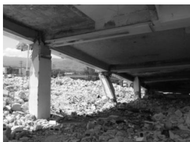
Figura 17.- Colapso parcial por la generación de rótulas plásticas en columnas-Haití. (Tomada de Carvajal, 2011)
