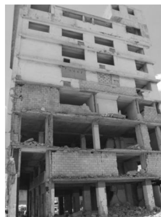
Figura 7.- Daño en muros debido a problemas de irregularidad-Haití.
