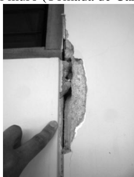
Figura 29.- Poca separación y efecto del choque entre muro y columna-Costa Rica.
