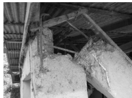
Figura 25.- Escaso anclaje del refuerzo longitudinal-Costa Rica. Nótese la ausencia de confinamiento. (Tomada de Carvajal, 2011)
