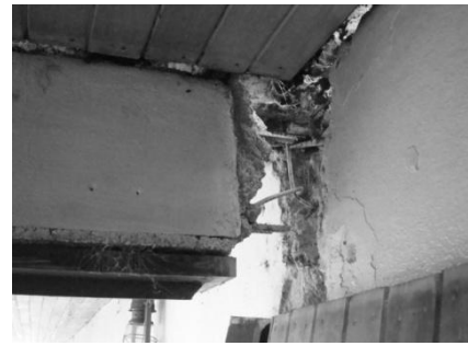
Figura 24.- Escaso anclaje del refuerzo longitudinal en unión de vigas-Costa Rica. (Tomada de Carvajal, 2011)
