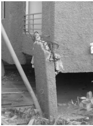
Figura 15.- Colapso por piso débil-Chile. Nótese transición entre columnas y muros.
