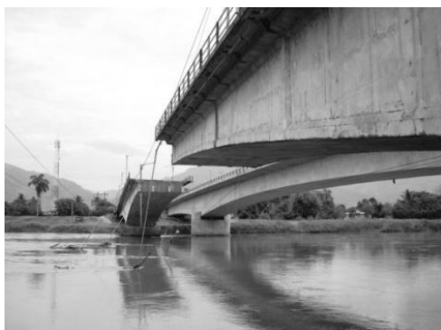
Figura 5.- Colapso total del tramo central del puente La Democracia producto del giro de sus bastiones y de la corta meseta de apoyo-Honduras. (Tomada de Carvajal, 2011)
