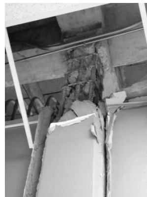
Figura 30.- Columna corta provocada por muros no sismo-resistentes-Honduras.
