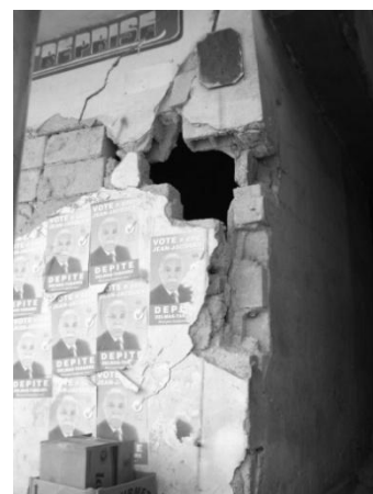
Figura 27.- Inadecuada unión entre paredes-Haití. Nótese la ausencia del acero de refuerzo.
