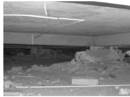
Figura 18.- Colapso total a causa de la generación de rótulas plásticas en columnas-Haití. (Tomada de Carvajal, 2011)
