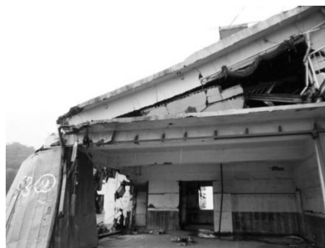
Figura 6.- Colapso del segundo piso y afectación del primer piso debido a la irregularidad en planta de la edificación-Japón.
