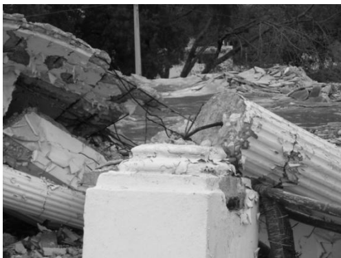
Figura 19.- Insuficiente acero de refuerzo en columna-Haití, Nótese la presencia de una única varilla en la columna y la losa de concreto desplomada al fondo –Chile. (Tomada de Carvajal 2011)
