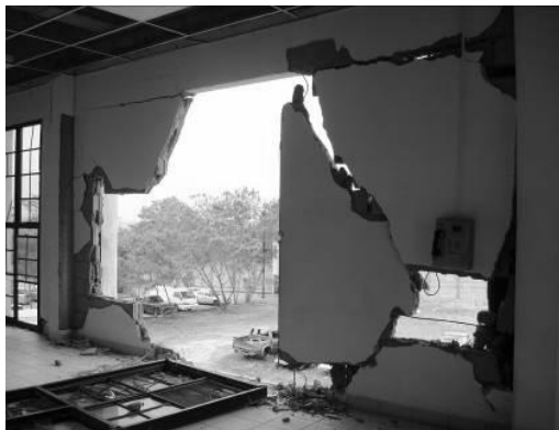
Figura 1.- Estructura notablemente dañada-Honduras. (Tomada de Carvajal, 2011)
